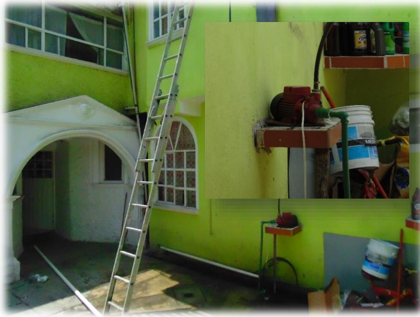
Ilustración 38 Sistema de bombeo y desperdicio de agua
