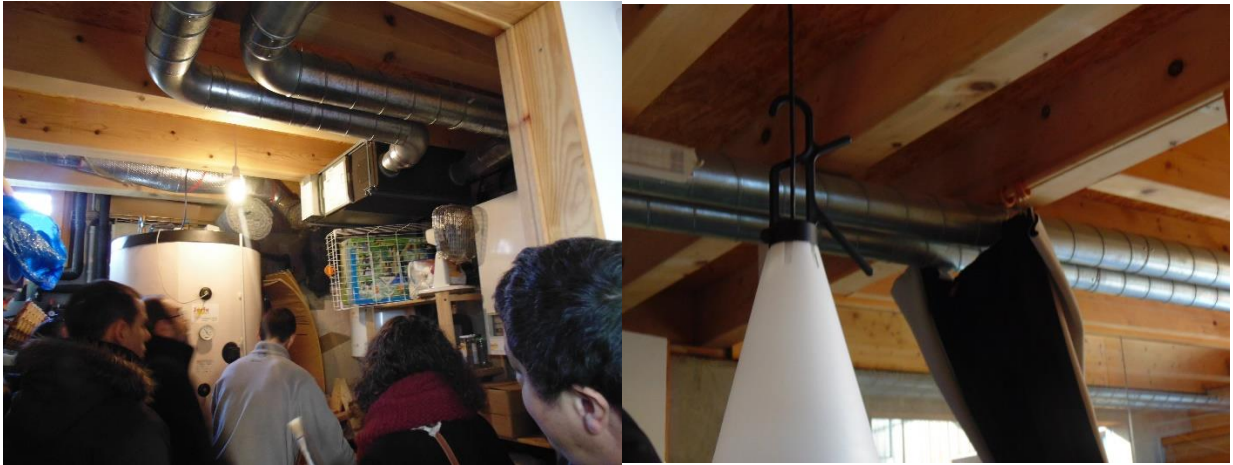
Ilustración 30 Instalación Casa Lleida
