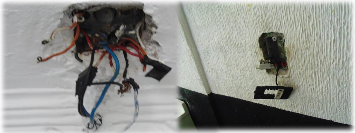
Ilustración 37 Fallas en el sistema eléctrico
