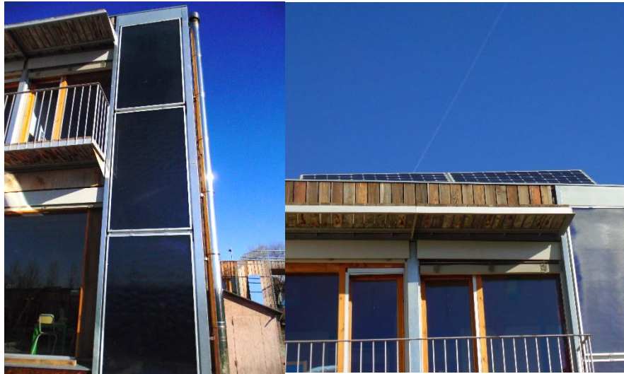
Ilustración 26 Colectores solare Casa Lleida
