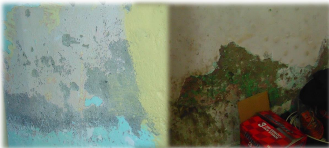
Ilustración 36 Síntomas de concentración de humedad alta
