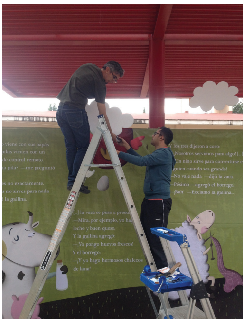
Imagen 135. Detalle del montaje de las nubes colgantes. Fotografía (2014): Geoffrey Hohmann.
