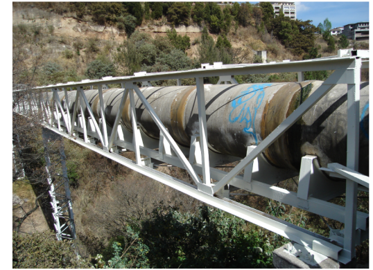
Colector Tamaulipas, Santa Fe. Sistema de Aguas, D.F. (Fotos de archivo de la empresa JICO) ▲
