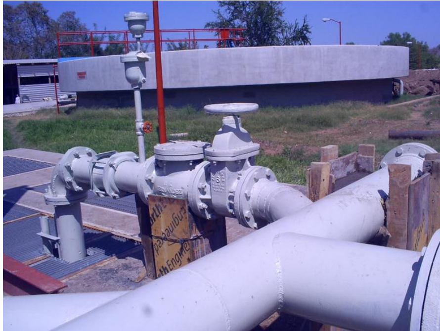
Obsérvese: Múltiple y tren de descarga conformados con piezas especiales de acero al carbón de 152 mm (6") de diámetro en cárcamo de bombeo de agua cruda.
