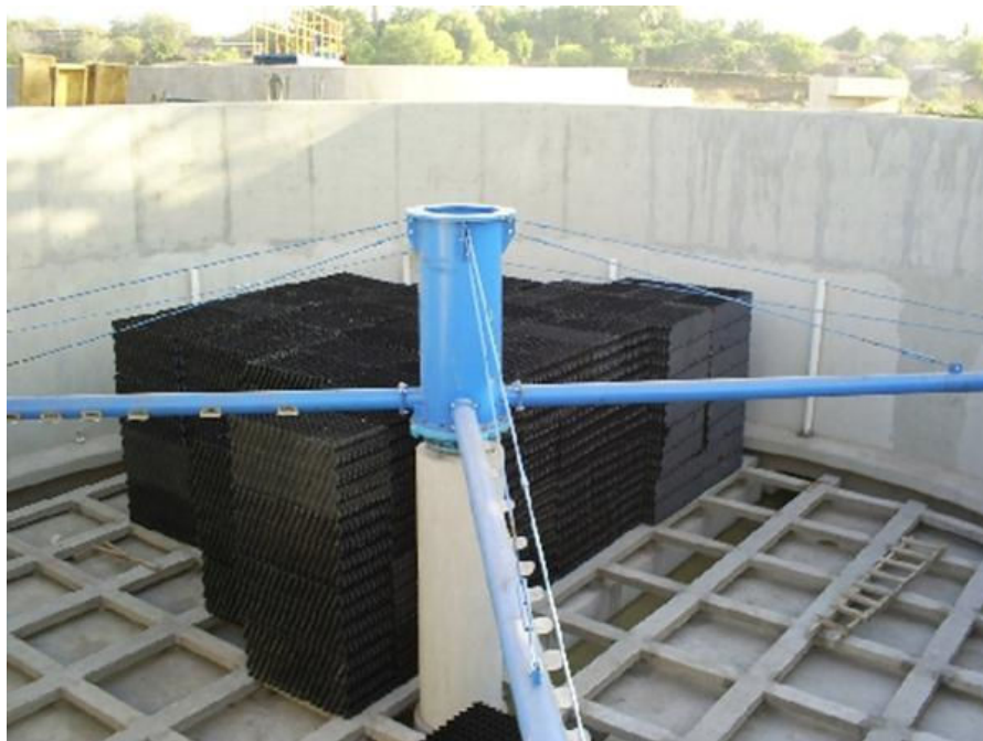
Obsérvese: El equipo mecánico montado en la columna central del filtro rociador además de la colocación de los módulos del empaque filtrante de pvc para darle mayor eficiencia al proceso de tratamiento, colocados sobre las trabes del falso fondo.
