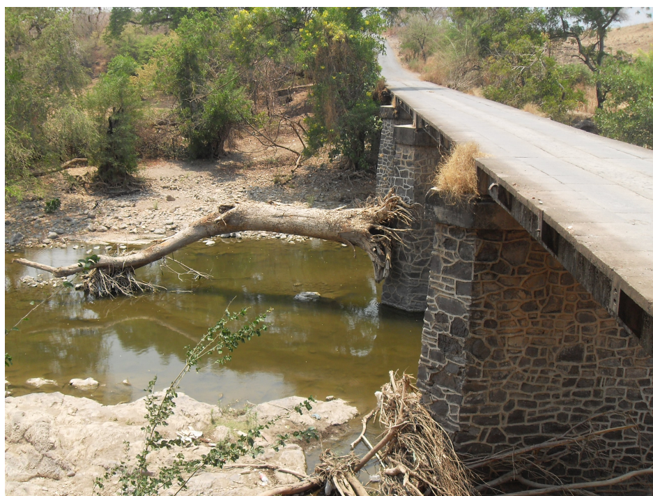
Figura 3.1: Puente con acumulación de escombros en la subestructura
